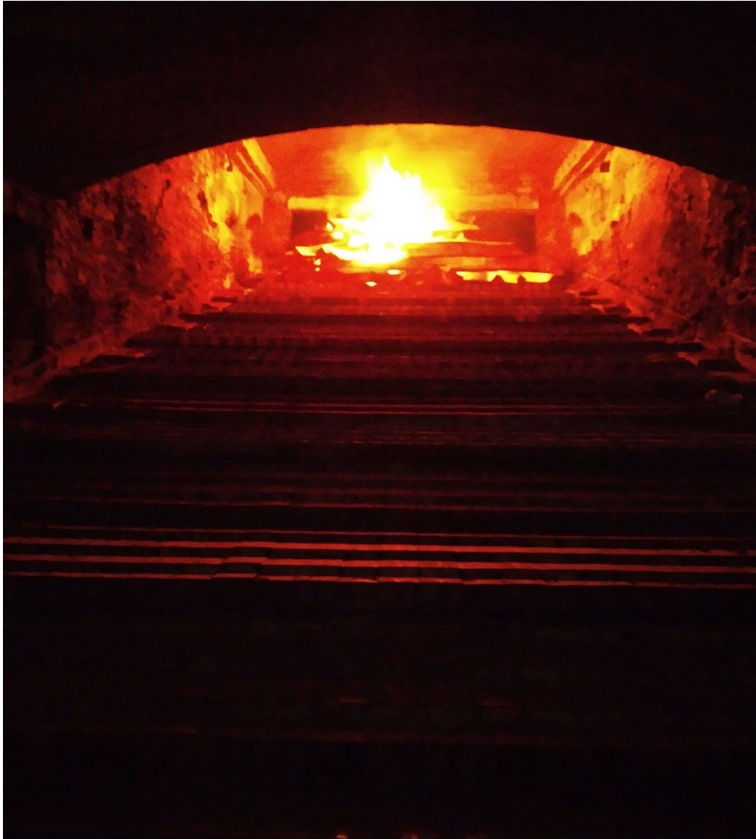
Bio1 hakelaitoksen käynnistys 15.11.2022
